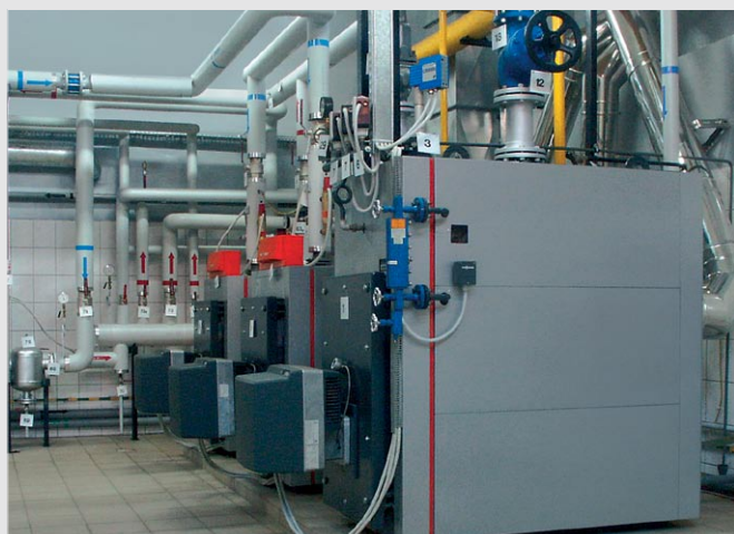
Instalacja kotłowni z niskoprężnym kocioł parowym Vitoplex 100-LS
