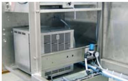
zintegrowany system chłodzenia w obiegu zamkniętym, bez przyłącza i zużycia wody
